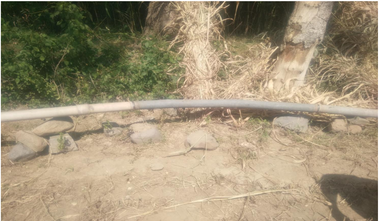
صورة توضيحية لتآكل انابيب الشبكة وقصها وتأهيلها
